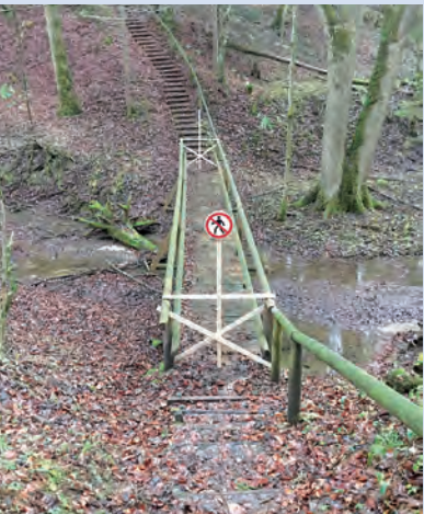
Marode Brücken wurden abgebaut oder gesperrt – wie hier am Salchstattgraben.
