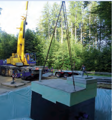
Gegen den hohen Wasserdruck: der neue Druckminderschacht.
