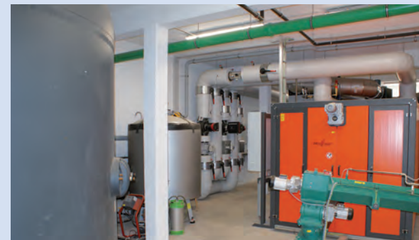
Das neue Heizwerk: imposantes High-Tech unter der Erde.
